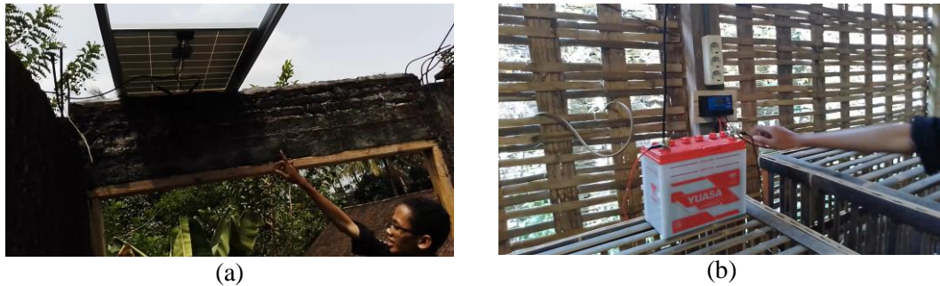
Gambar 7 Pembangkit Listrik Tenaga Surya (a) solar panel (b) aki
