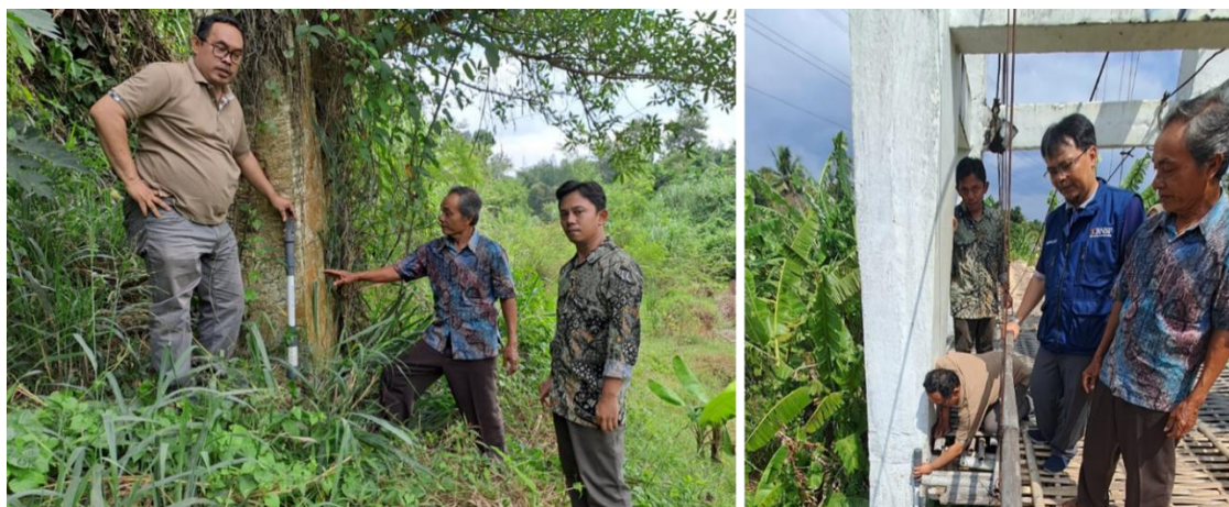
Gambar 5 Pemasangan alat EWS di beberapa tempat sekitar sungai Ciseel
