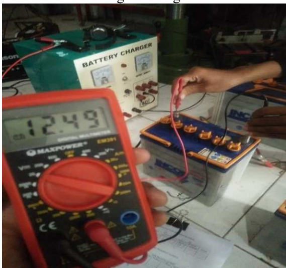
Gambar 9. Mengukur Voltase Akhir Tiap Baterai
