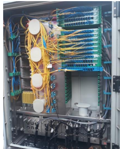
Gambar. 4 Optical Distribution Cabinet (ODC)
