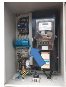
Gambar. 8 Instalasi Arrester pada BTS telkomsel
