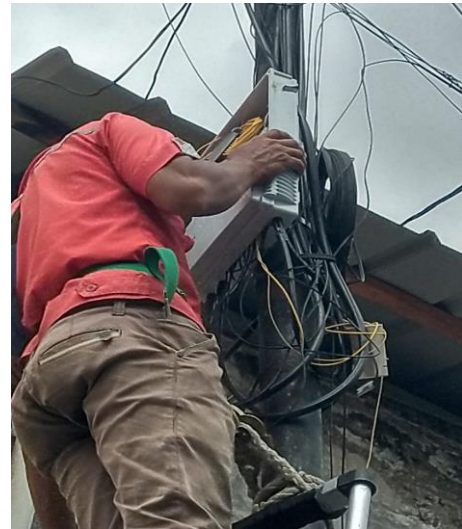
Gambar. 7 Pengecekan dan pemeriksaan ODP.
