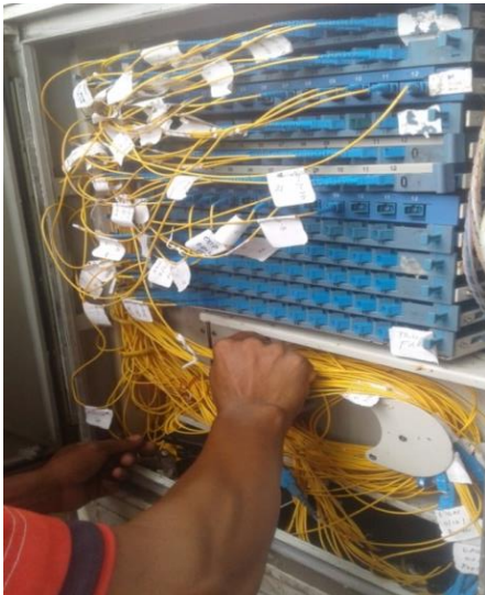
Gambar. 5 Pemeriksaan splitter pada ODC.
