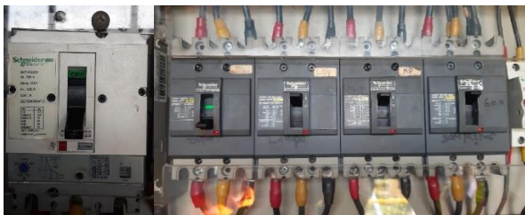
Gambar 5 MCB Pada MCC Panel BLC
