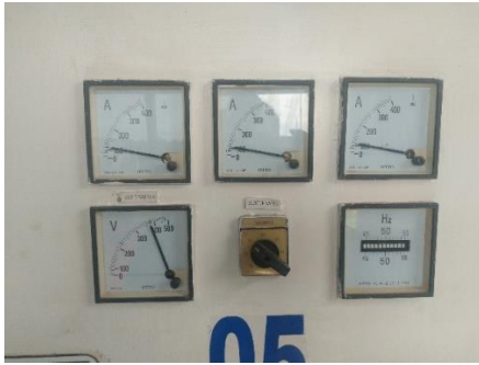
Gambar 3 Instrumen pada MCC Panel Box BLC
