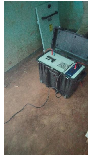
Gambar. 1 Pemasangan Transmitter dengan PHB
