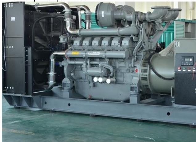
Gambar 3.2 Mesin generator set yang dimiliki Bandar Udara Internasional Kertajati
