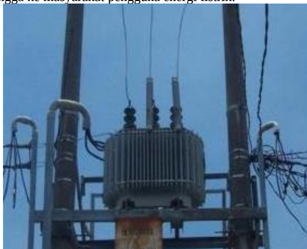
Gbr. 1 Trafo Tiang
