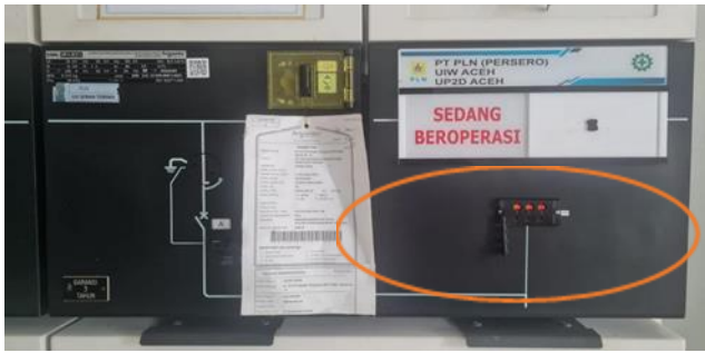
Gbr. 3 Terminal Uji Tegangan Kubikel
