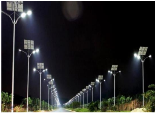
Gbr. 1 Penerangan Jalan Umum Tenaga Surya
