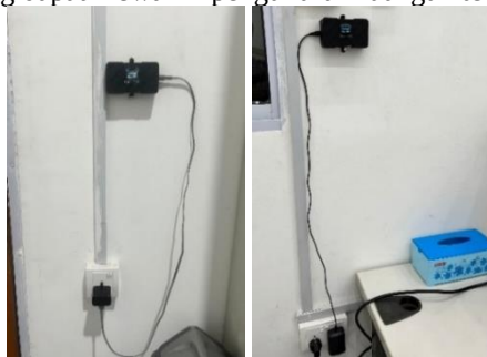
Gbr.17 Lokasi Penempatan Alat Suhu dan Kelembaban
