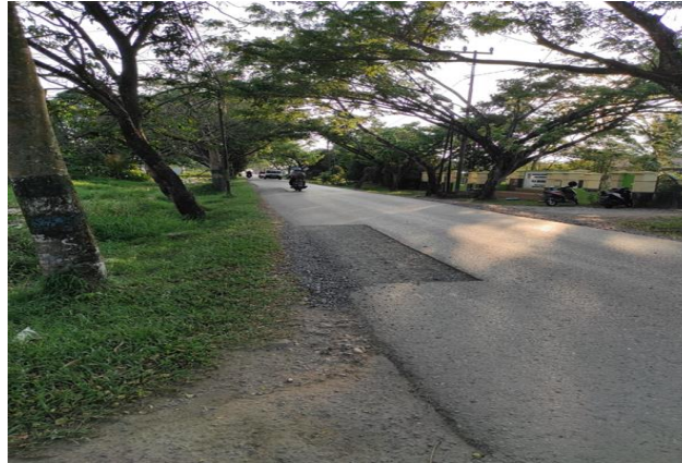
Gambar 1. Kondisi Ruas Jalan
